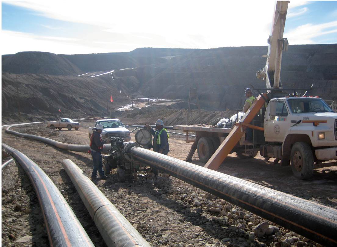
Figura 3.6 OperaciOnes de Construcci3n de la Conducci3n de Suministro de Agua a una Mina
